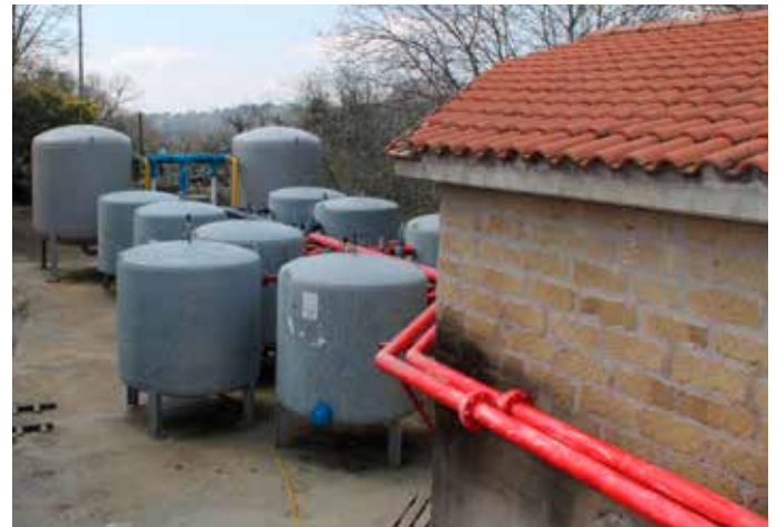
Impianto di filtraggio e dearsenificazione delle acque
